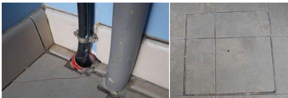
Exemples de défauts d'étanchéité
